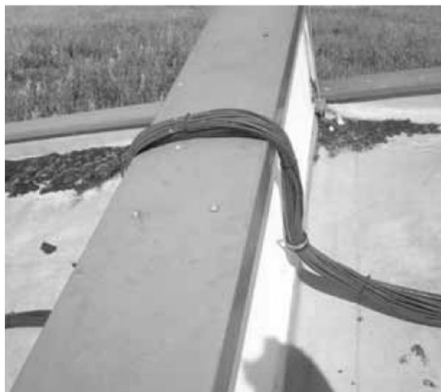
Nicht erlaubte Verlegung von Leitungen über eine Brandwand
