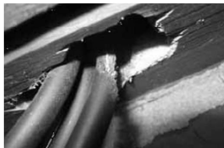
Beschädigungen von Leitungen
