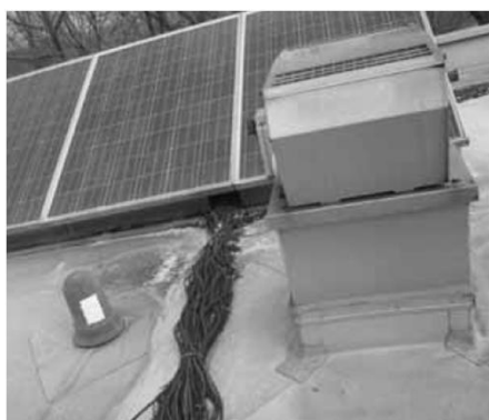
Nicht fachgerechte Leitungsverlegung
