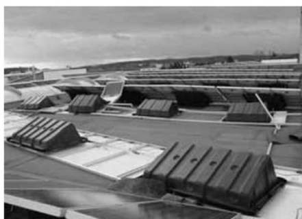
Sturmschaden durch Nichtbeachtung der Systemstatik
